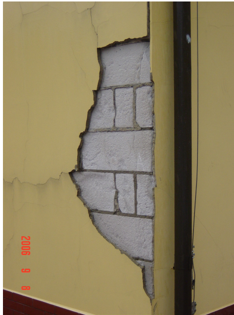
Korozja mrozowa – odspajanie tynku od ściany z betonu komórkowego (fot. J.Sz.)
